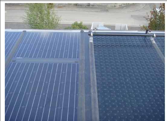
Links ZRE-Module – rechts AS- Kollektoren
