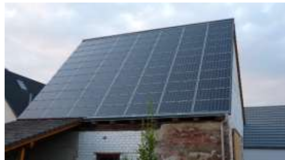
Bild 12: Fertige PV Anlage
